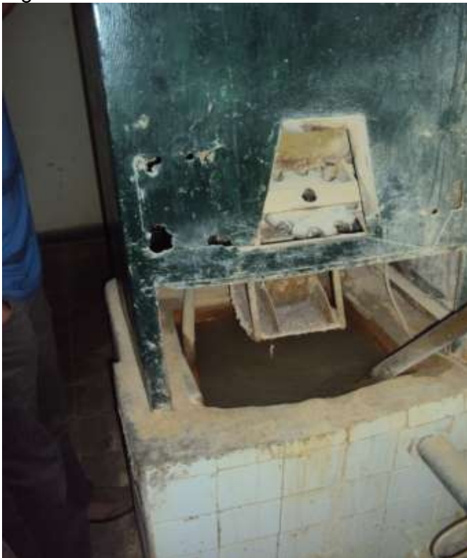
Figura 6. Dosificador de Sulfato de Aluminio de PTAP Vélez.
