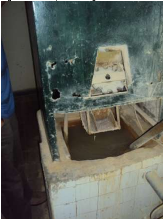
Figura 39. Tanque de coagulación.
