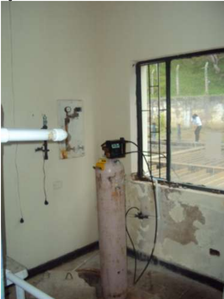
Figura 10. Sala de cloración.
