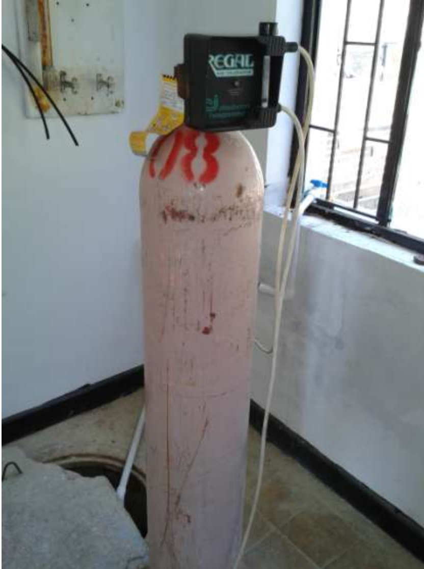
Figura 7. Cilindro de cloro gaseoso PTAP Vélez.
